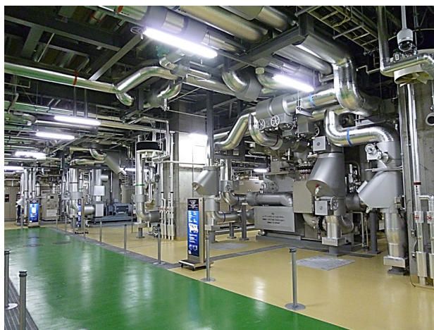
認定の更新を受けた東京スカイツリー地域熱供給施設
