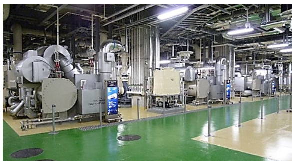
ターボ冷凍機（メインプラント内）
